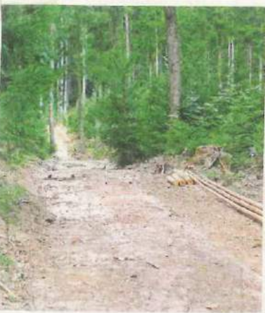
Ist die Holzernte abgeschlossen, werden die Wege – wenn nötig – repariert. Wie hier im Hellingner Grund.
